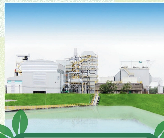
โรงไฟฟ้าพลังงานสะอาด สิรินธร
